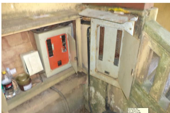
Figura 2 - Quadro Geral de Entrada
