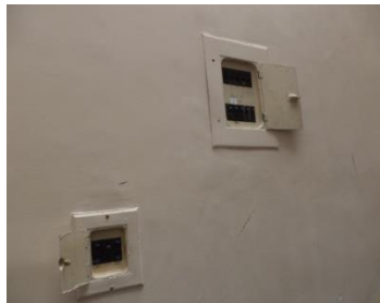
Figura 4 - Quadros elétricos sem conceito de distribuição
