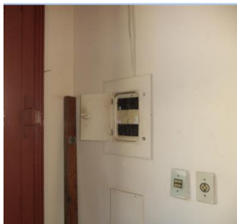
Figura 5 - Quadro elétrico sem identificação
