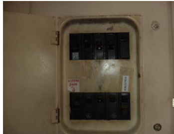
Figura 3 - Quadro Elétrico sem identificação dos circuitos
