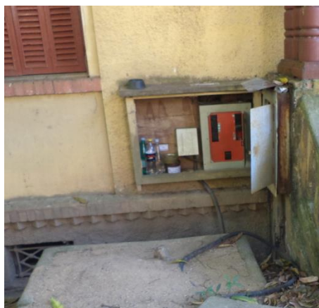
Figura 1 - Quadro Geral de Entrada
